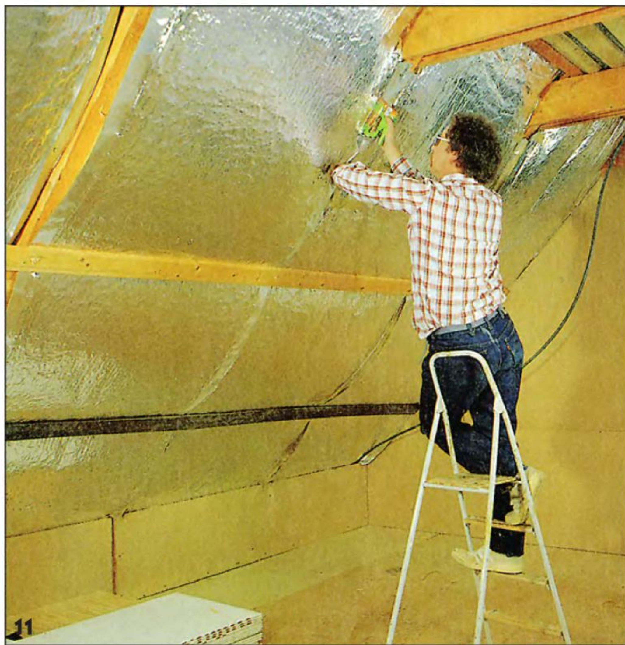
Конструкция крыши состоит из стропильных ферм с ригелями. Уложенную между стропилами теплоизоляцию теперь можно закрепить скобами окончательно. Расстояние между стропилами здесь — 1,15 м. Уложенную теплоизоляцию удерживают вспомогательные рейки.
