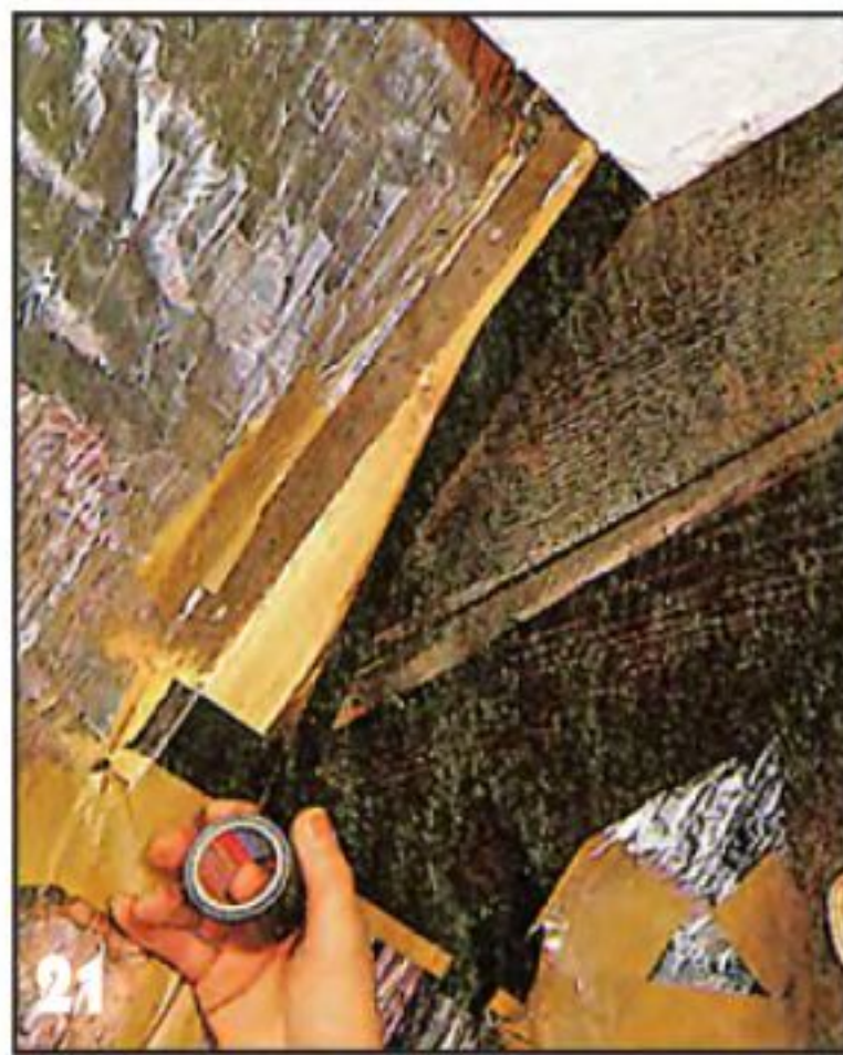
21 В зоне теневого шва бруски укрывают чёрной самоклеящейся лентой или окрашивают чёрной краской.
