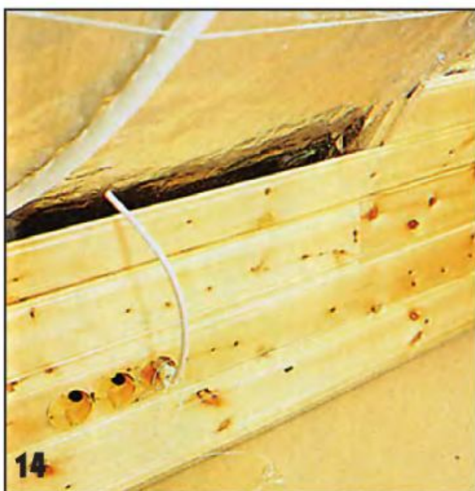
14 Теперь в обшивку надо врезать антенные розетки и подключить к ним кабели.
