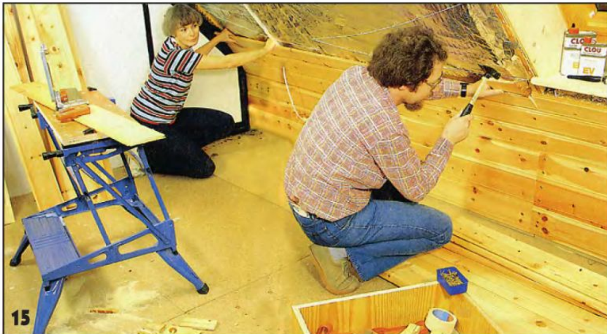
15 В качестве вспомогательного монтажного бруска используют отрезок шпунтованной доски с обрезанным гребнем. При расстоянии между стропилами 1,15 м изоляционные маты будут слегка провисать в середине, оказывая давление на доски обшивки. Чтобы уменьшить нагрузку на обшивку, между стропилами натягивают удерживающие шнуры. За досками монтируют ещё и трубу для последующей прокладки электрокабеля и установки потолочных громкоговорителей.
