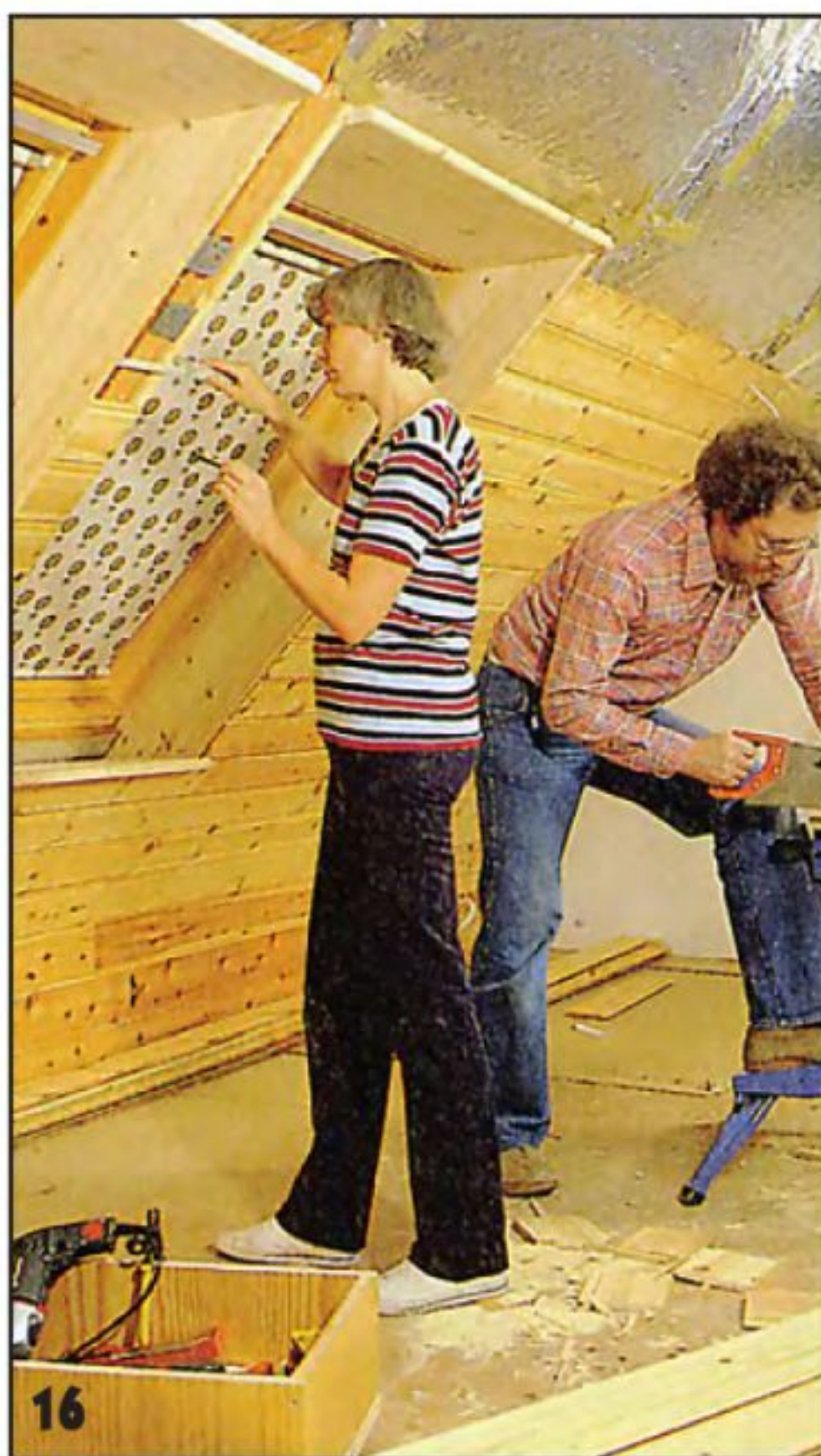
16 Здесь стропило между мансардными окнами, расположенными в плоскости крыши, обшивают короткими дощечками (отрезками шпунтованных досок).
