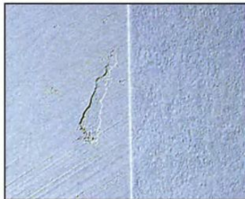
Оштукатуренную стену с мелкими трещинами можно оклеить обоями из нетканого материала, которые хорошо зарекомендовали себя как основа под отделку стен растушёвыванием.
